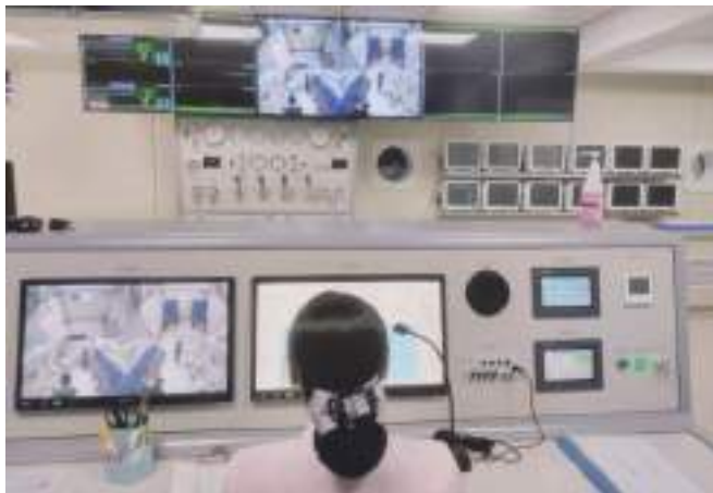
全自动电气操作台
